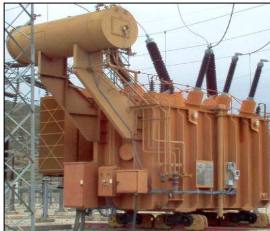
Fig. 1. Autotransformador No.2 de la Subestación Barquisimeto, Venezuela.
