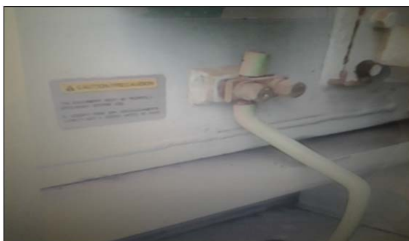
Fig. 3. Conexão de posta a terra de geradores.
