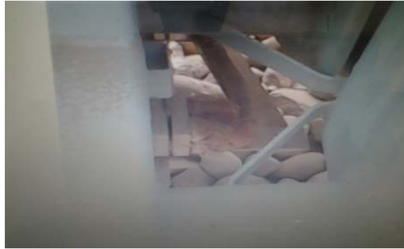
Fig. 4. Conexão de posta a terra de transformadores.
