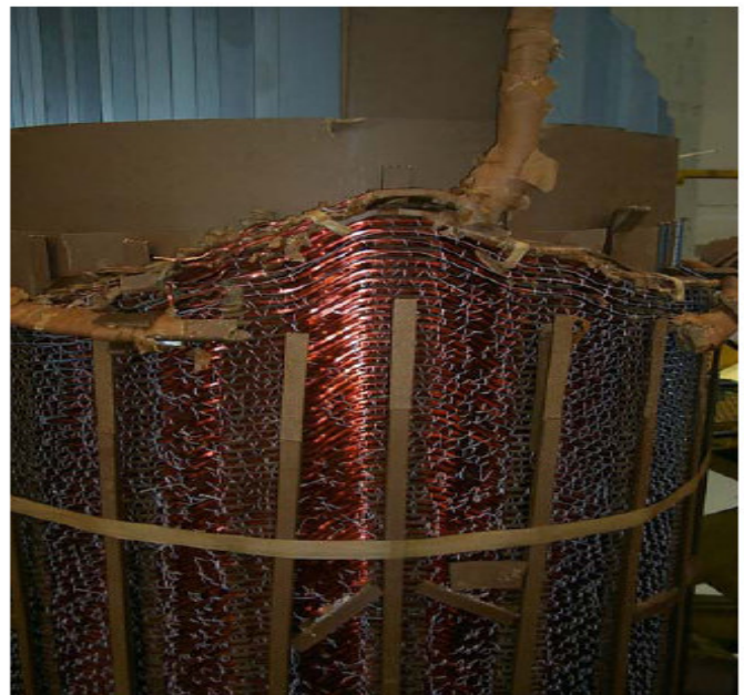
Daño en el devanado BT2.
