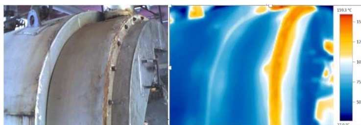
Fig. 5. Imagen real y termográfica de la cara posterior de la caldera.
