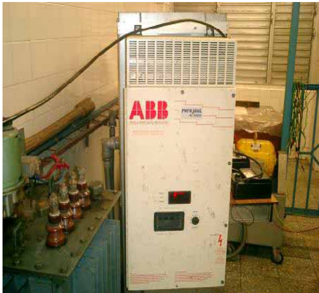
Variador de frecuencia ABB.
